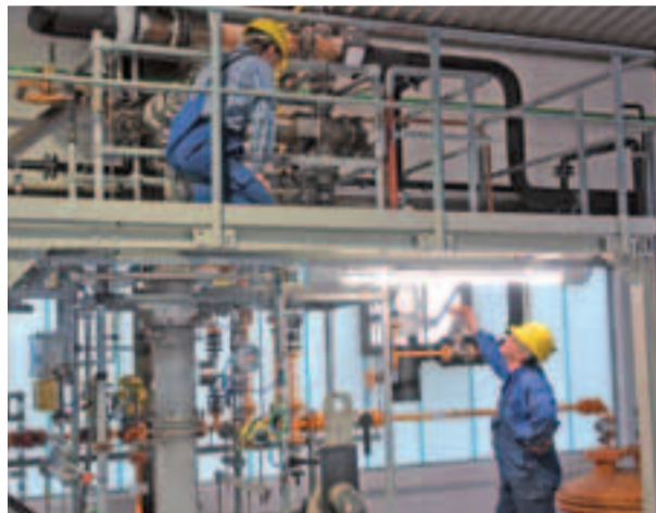
Matthias Marek und Bernd Maier in der neuen TFAH-Anlage.
